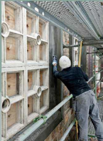
Restauration à l'identique des claustras de l'église Sainte-Suzanne, Schaerbeek. Identieke restauratie van de claustra's van de Sint-Suzannakerk, Schaerbeek.
