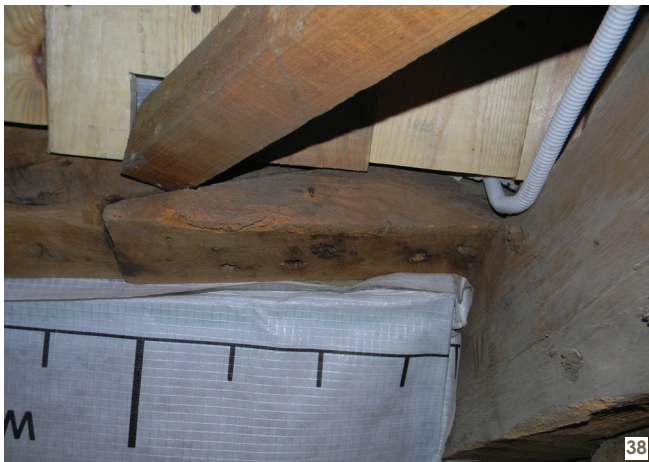
38 Panne reposant sur le second faux-entrait, renforcée par le lien US 105 . photo : V. Moulaert. © BUP-DMS
