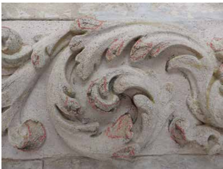
La Brouette. Détail d'un motif de rinceaux avec marquage à la craie rouge des parties à réparer au mortier de ragréage. Pierre d'Euville (© CPH, 2014).
