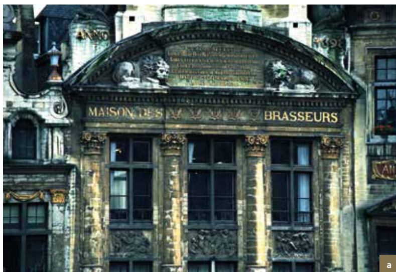
La Maison des Brasseurs . a) état avant restauration : attaques biologiques (mousses), salissures et croûtes noires (pollution atmosphérique), coulées d'oxydes métalliques, etc. (© CPH, 2000) ; b) état après restauration, page de droite (© Utopix, M. Ploton, 2018).
