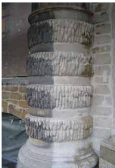
La Maison des Brasseurs . Essai de nettoyage. Détail des bossages rustiques des colonnes. Pierre de Balegem. Technique hydropneumatique de rotations-tourbillons à basse pression (© CPH, 2004).
