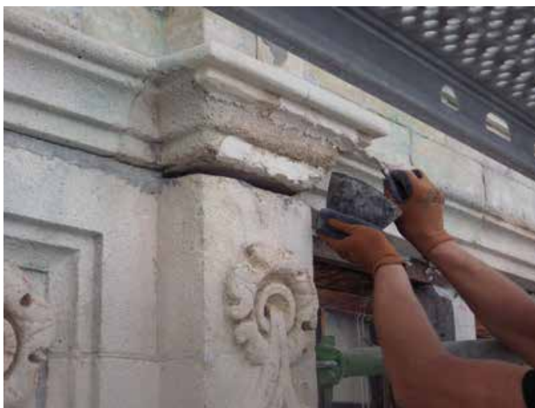
La Brouette. Moulures en cours de restauration, réparation au mortier de ragréage. Pierre d'Euville (© CPH, 2014).
