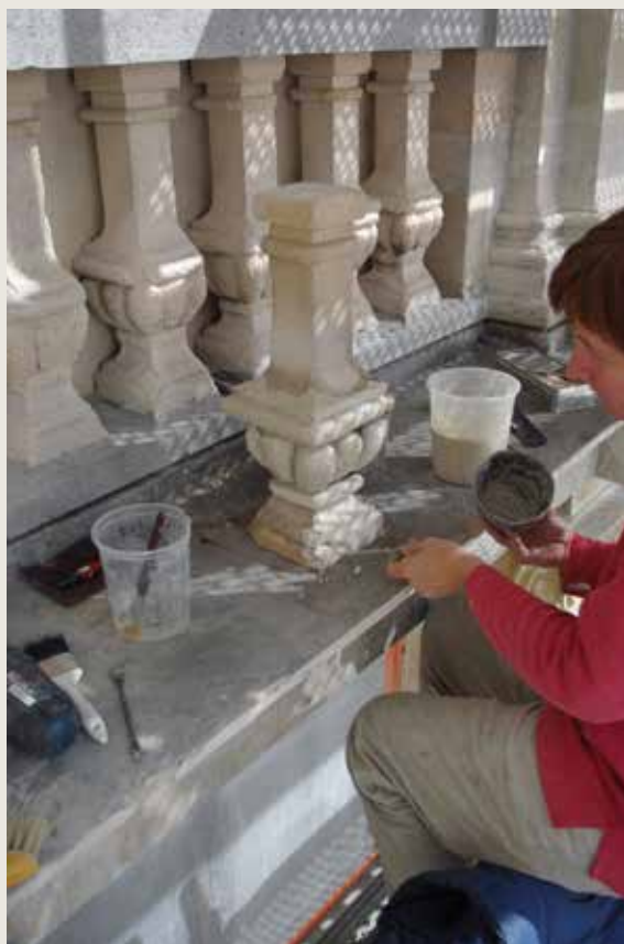
Le Pigeon . Détail d'un balustre en cours de restauration, réparation au mortier de ragréage. Pierre d'Euville du type marbrier (© CPH, 2012).
