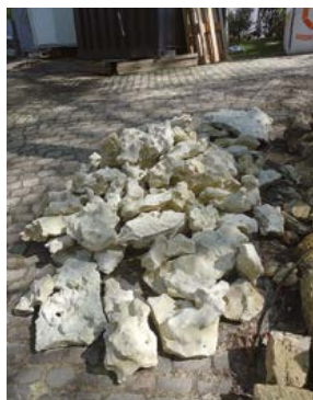
Fig. 5 Pierres de grès fistuleux déposées sur le chantier de restauration (photo de l'auteur).
