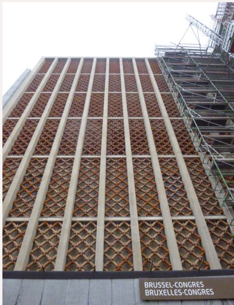
Façade de la gare de Bruxelles-Congrès. Le parement de pierre bleue et de claustras en briques (© SPRB).
