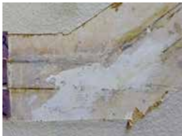
Fig. 8 Traces des moulures disparues sur les murs du hall. Anciens traits de crayon et réparation des anciens trous de clous (© Arsis bvba, 2017).
