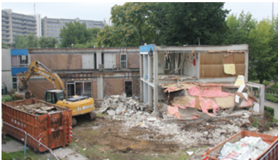
FIG. 6 En 2016, certains modules ont été démolis pour faire place à l'agrandissement de la piscine de la VUB (© VUB Architectural Engineering, 2016).
