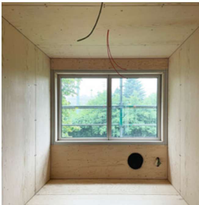
FIG. 28 Vue de la finition intérieure du «cocon» pendant le chantier, montrant la découpe destinée à l'unité de ventilation individuelle (© MAKER architecten, 2024).
