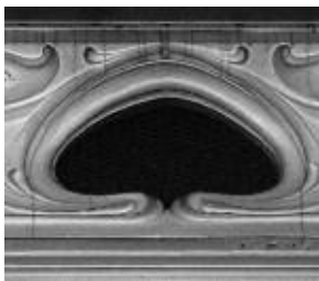
Bouche d'aération de l'ancien système de chauffage.
