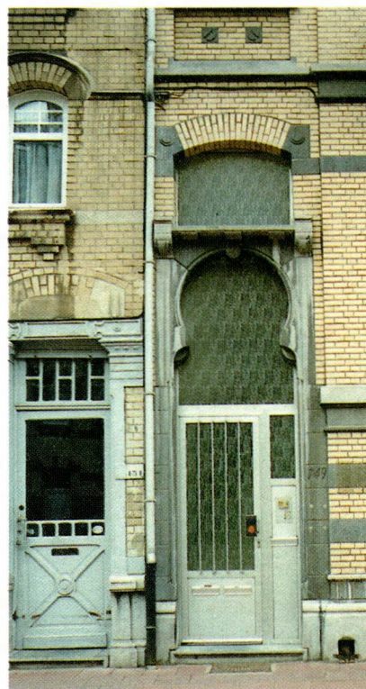
Les nouveaux matériaux et leur mise en œuvre sont parfois totalement incompatibles avec les matériaux d'origine et le dessin de la façade
