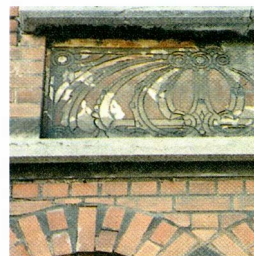
Dégradation du sgraffite intervenir à temps
