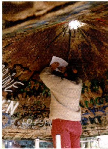
1] CASCADE ENVAHIE PAR LA VÉGÉTATION, PARC JACQUES FRANCK, SAINT-GILLES. 2] DÉGRADATIONS DUES AU VANDALISME, GLORIETTE, PARC TEN REUKEN, AUDERGHEM.
