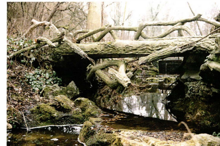
DÉGRADATIONS LIÉES AU VIEILLISSEMENT DES MATÉRIAUX, PARC PARMENTIER, WOLUWE-SAINTE-PIERRE.
