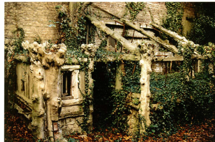
DÉGRADATIONS LIÉES AU MANQUE D'ENTRETIEN, SERRE, PROPRIÉTÉ PRIVÉE.
