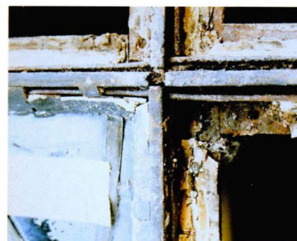
La corrosion touche aussi les éléments de fixation et les armatures métalliques. Le cas le plus fréquent est le vieillissement des plombs qui se manifeste surtout par la perte de leur résistance mécanique. Sous l'effet du gaz carbonique, le plomb se transforme en carbonate de plomb virulent et la matière devient poreuse et cassante. On observe également la dégradation des barlotières qui se couvrent de rouille.
