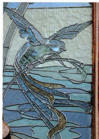
Quelquefois, pour maintenir un élément ou masquer une fêlure, il est nécessaire d'ajouter une bande de plomb. Place Morichar 41, Saint-Gilles.
