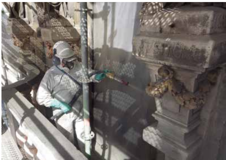
De Vos , reiniging ter hoogte van de sokkels van het beeld van Justitia (Pierre Comein, 1884). Euvillesteen. Reiniging met een roterende hydropneumatische lichtedrukstraal (© CHE, 2014).
