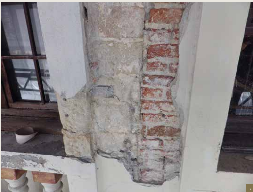
Bepleistering van sommige gevels. a) De Roose . Bepleisteringstest; b) Het Vosken en Den Eycke . Werken in uitvoering; c) Het Vosken en Den Eycke . Het afbikken van delen waar de bepleistering loskomt (© CHE, 2008 en 2015).
