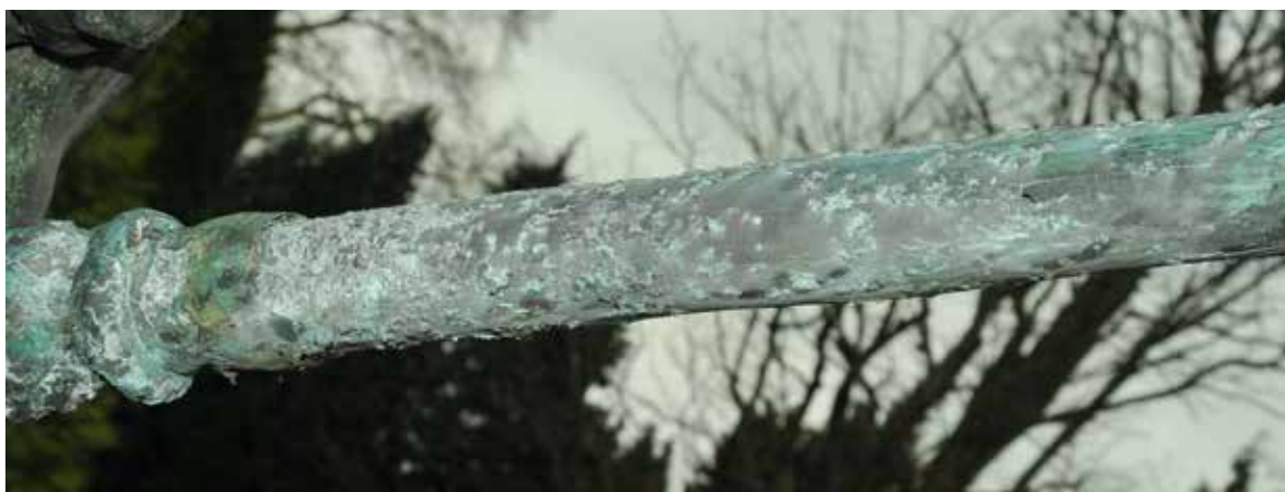
Afb. 11c Actieve corrosie van het aluminium (© Metafose).
