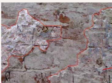
Overblijfsel van het oorspronkelijke pleisterwerk met imitatiebaksteen (S. Modrie © GOB-ULB).
