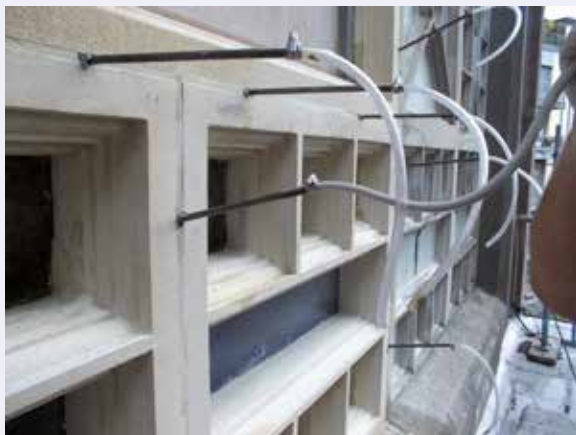
Afb. 15 Injectie met alkalische mortel om de holtes en grindnesten die raken aan de wapeningen te vullen [G. Stegen, 2018 © ARSIS].
