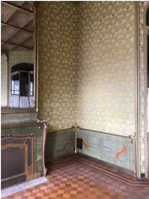
AFB. 10A Het salon aan de straatkant: in de hoek onderaan de plint in onyx situeert zich een afsluitbaar ventilatierooster in messing waarlangs de verse lucht vanuit de kelder wordt binnengebracht (nr. 2 in afb.11) (© B. Van der Wee Architects, 2020).
