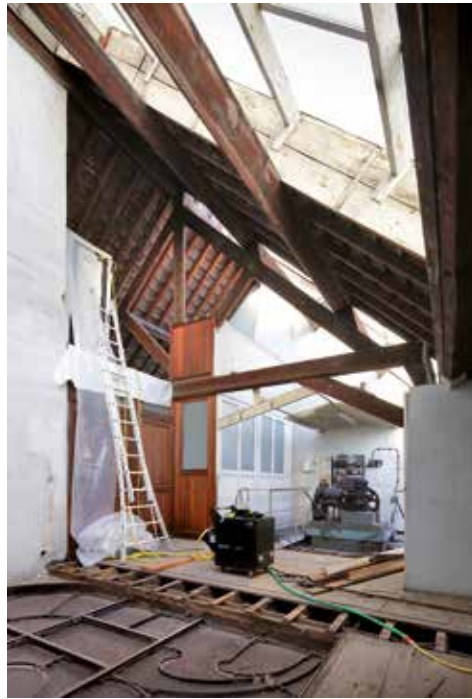
AFB. 15 Op de zolder van het grote dak is in het dakvlak aan de noordkant duidelijk zichtbaar waar de originele glaspartij was geplaatst, die later werd dichtgelegd. Op de vloer van de zolder zijn twee lichtkoepels te zien die het daglicht boven de privétrap en de diensttrap binnenbrachten (foto Filip Dujardin, 2019).
