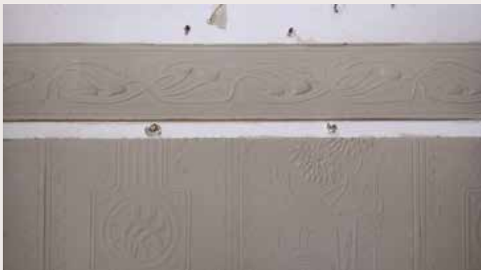
AFB. E3.1 Twee lincrustas opgebracht op de midden- en de beneden registers in de eerste kamer, eerste verdieping van het voormalig huis van Louise de Hem (Ernest Blérot, 1902); het is wel zichtbaar dat twee lijsten werden afgenomen/uitgetrokken voor het bouwen van een wandkast (© foto van de auteur, 2019).
