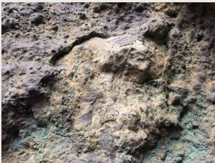
AFB. 7 Detail van de muur: door een gat in de raaplaag is zandsteen zichtbaar. De groene verf die zichtbaar is op de steen, toont aan dat ze werd aangebracht nadat de raaplaag verdwenen was (© F. Lombaers).
