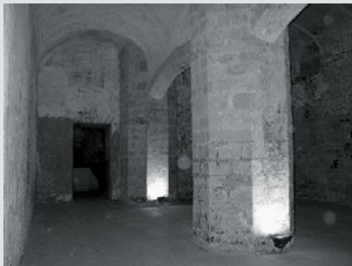
De kelderverdiepingen van de kapel. De achthoekige pilaren ondersteunen de gewelven die deze opslagruimtes overdekten.
