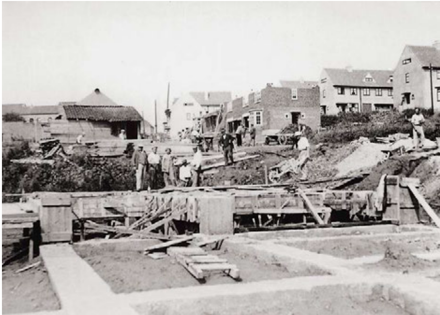
Voor de funderingen werd bekist beton gebruikt terwijl de vloer op de benedenverdieping van de onderkelderde huizen gevormd werd door betonnen liggers, Le Logis. Foto 1932-1933.
