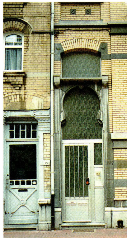
De nieuwe materialen en de aanwending ervan zijn soms totaal onverenigbaar met de oorspronkelijke materialen en de gevelcompositie.
