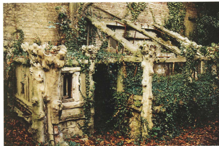
SCHADE DIE VERBAND HOUDT MET HET GEBREK AAN ONDERHOUD, SERRE, PRIVÉ-EIGENDOM.
