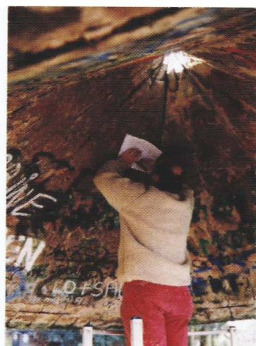
1] WATERVAL OVERWOEKERD DOOR PLANTEN, JACQUES-FRANCK-PARK, SINT-GILLIS. 2] SCHADE DOOR VANDALISME, PRIEELTJE, PARK TEN REUKEN, OUDERGEM.
