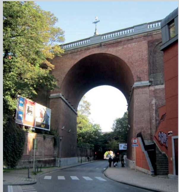
Avenue de la Couronne / rue Gray, viaduc enjambant la vallée du Maelbeek (© SPRB - IGOB photo 2011) Kroonlaan / Graystraat, viaduct over de Maalbeekvallei (© SPRB - IGOB photo 2011)
