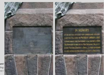
Plaque commémorative avant et après traitement. Gedenkplaat voor en na behandeling. (© Metafusa)
